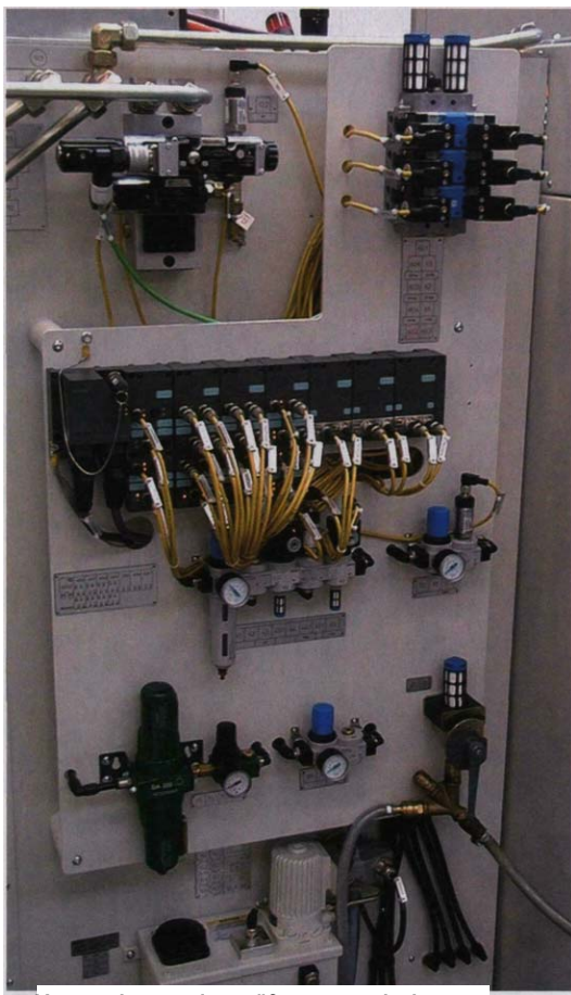
4 Vormontierte und geprüfte pneumatische Funktionseinheit
